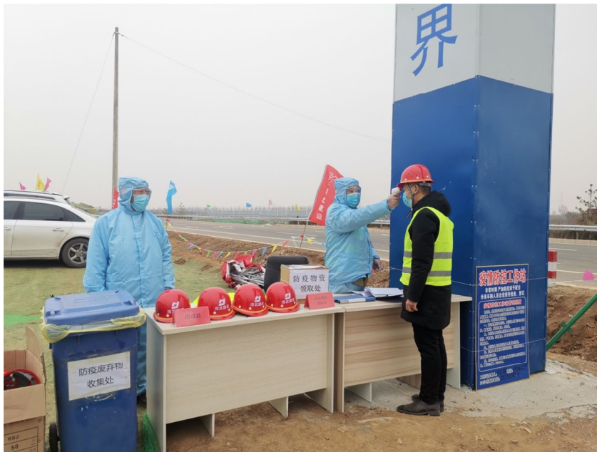
▲位于保定市徐水区大王店镇的容易线 RYSG1 标段分离式立交桥项目 正为入厂人员测体温
